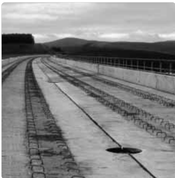
Brücke ins Nichts? Auf der anderen Seite wollen noch 80 km Tunnel und Brücken gebaut werden.
