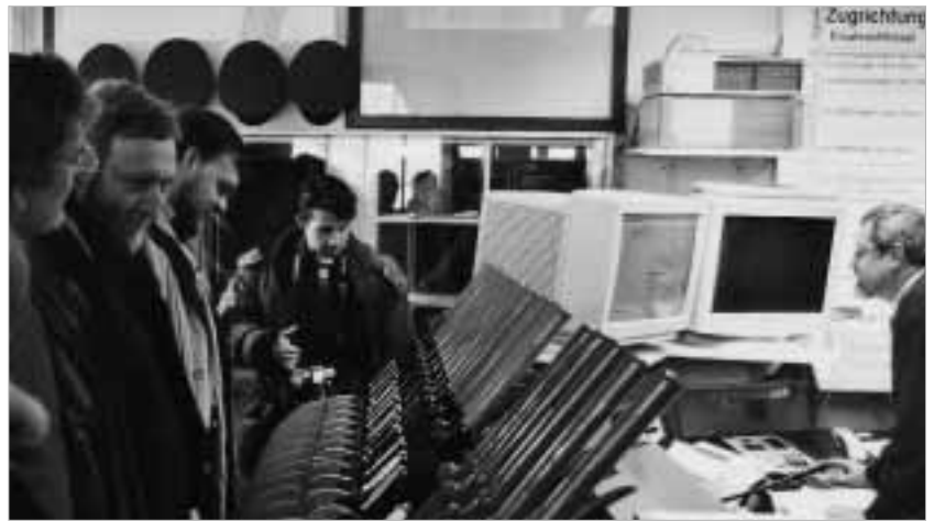
Lernen auf den Exkursionen: Besuch im Stellwerk Gammertingen der Hohenzollerischen Landesbahn. Verblüffend: die Kombination von elektronischem und mechanischem Stellwerk.
